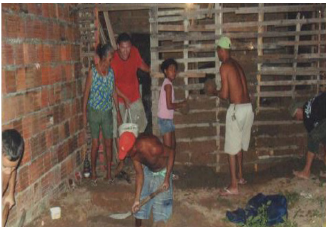
Imagem 02: Moradores construindo sua moradia na comunidade Rosalina. Fonte: Arquivo particular da Associação Comunitária da Rosalina, s/d.
